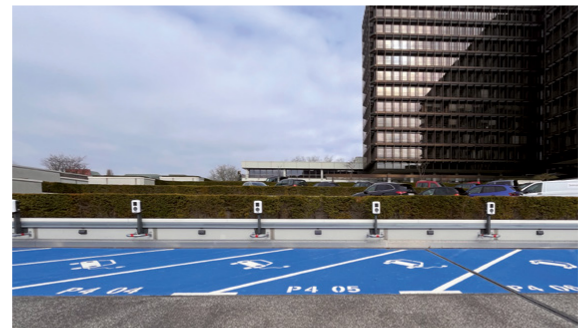
Die Ladesäulen am Überseering 35 sind öffentlich zugänglich.
