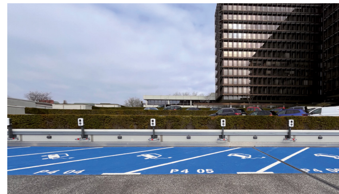
Die Ladesäulen am Überseering 35 sind öffentlich zugänglich.
